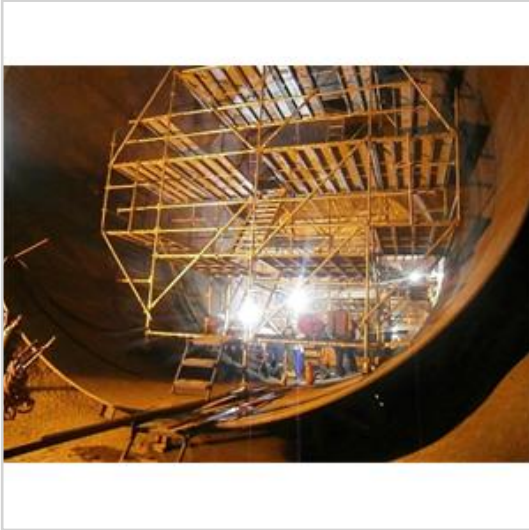
Hidroelektrik Santrallerinde Kullanılan Cebri Borular
