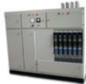
630 kVA A.G. Dağıtım Panosu
