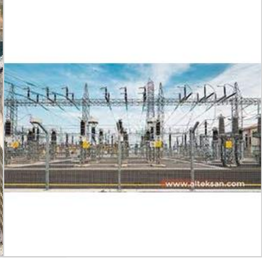
Elektrik Enerjisini Elektrik Santrallerine Aktarılan Trafo Merkezleri
