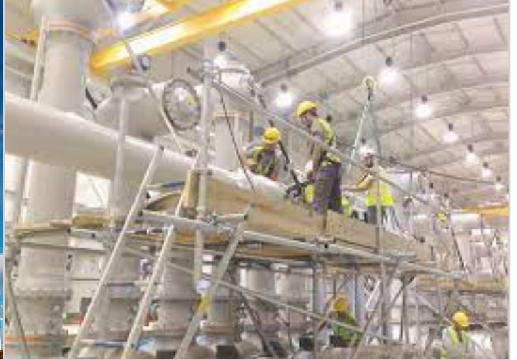
Şehir İçerilerine Taşınmasında Kullanılan Gaz İzoleli Şalt Merkezleri (Trafo Merkezleri)
