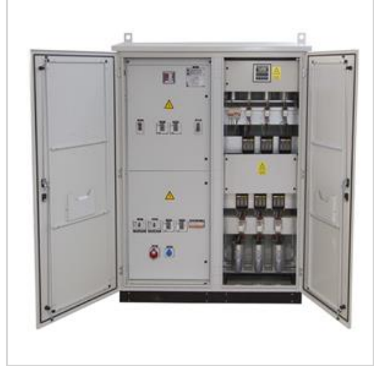
Elektrik Enerjisinin Ana Dağıtım Panosu
