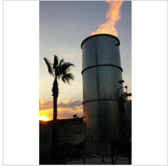
Gaz Yakma Bacası
