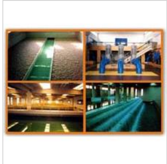
İçme Suyu Arıtma Tesisleri
