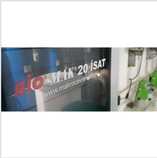
Paket İçme Suyu Arıtma Tesisi
